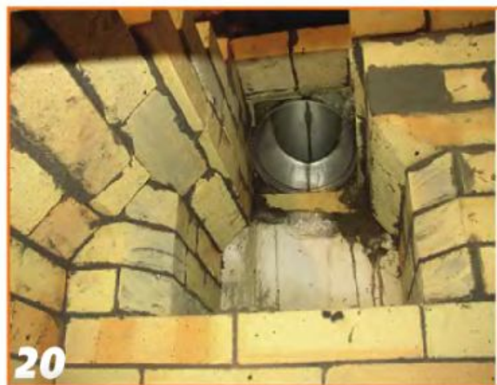
Так выглядит дымосборник изнутри. На фото виден металлический отвод в уличную трубу.
