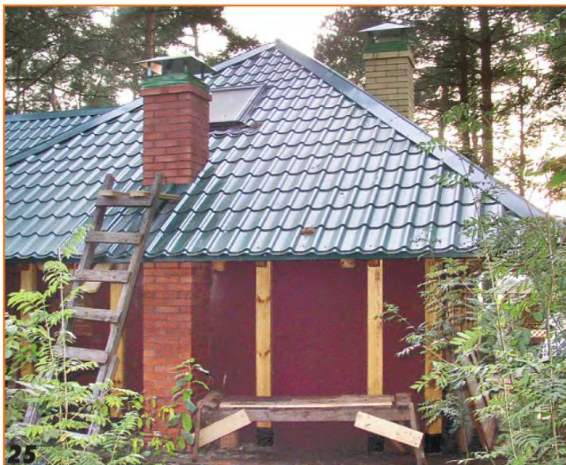
25 Уличная труба — дымоход от плиты и гриля.
