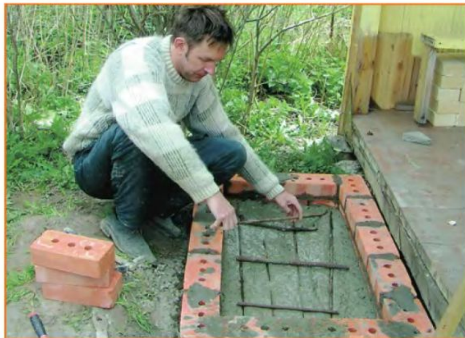
От грунта основание подняли на 2 ряда кладки. Кладку выложили только по периметру, а внутри залили бетоном.
